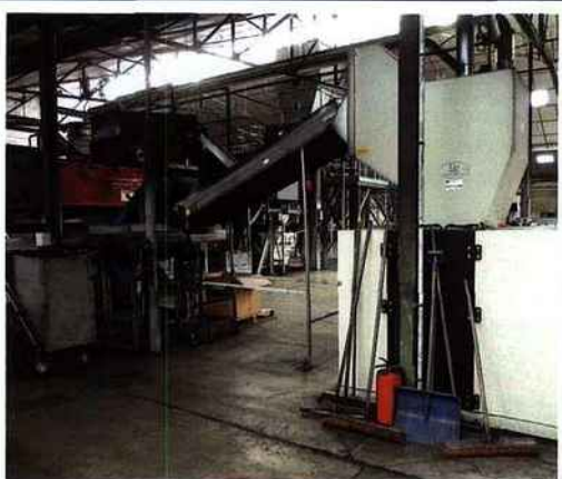
7. La deuxième partie de l'installation traite les matières plastiques et l'inox.
